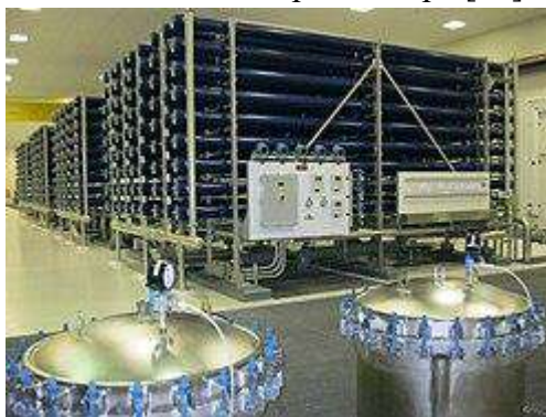
Figura 2. Instalație de osmoză inversă [11].
