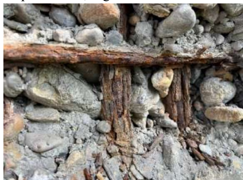
Figura 3. Exfolierea betonului și expunerea armăturilor
