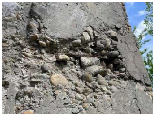
Figura 4. Agregate cu dimensiuni mari la suprafața betonului
