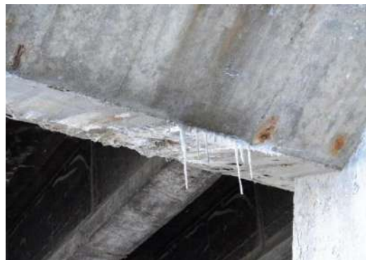
Figura 2. Formarea stalactitelor pe elementele structurale
