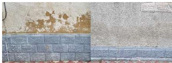
Figura 2. Măsura diferită a degradărilor – în stânga fațada sudică, în dreapta fațada nordică.
