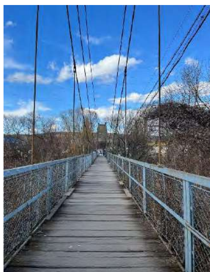
Figura 10. Uzura căii pe pod
