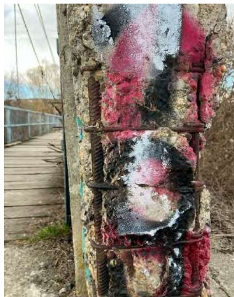
Figura 7. Exfolierea stratului de acoperire cu beton
