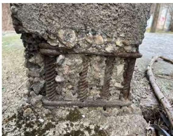
Figura 4. Exfolierea stratului de acoperire cu beton
