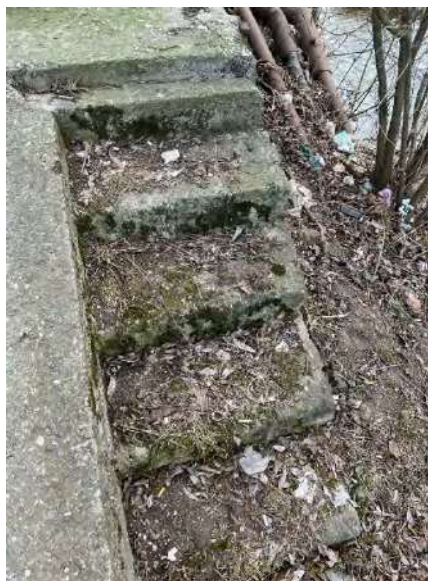
Figura 13. Degradări ale căii de acces
