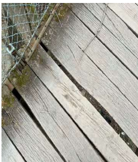
Figura 11. Uzura căii pe pod
