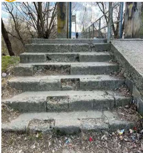
Figura 12. Degradări ale căii de acces
