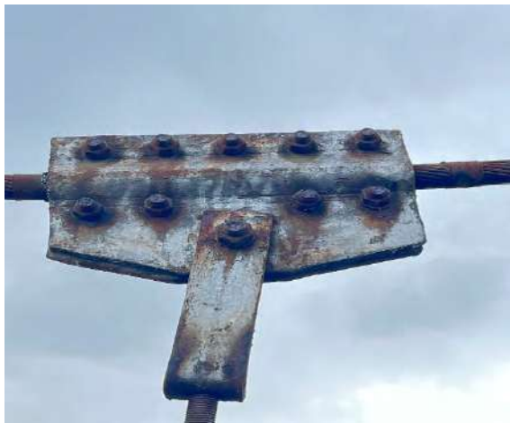
Figura 1. Uzura cablurilor și a elementelor de susținere
