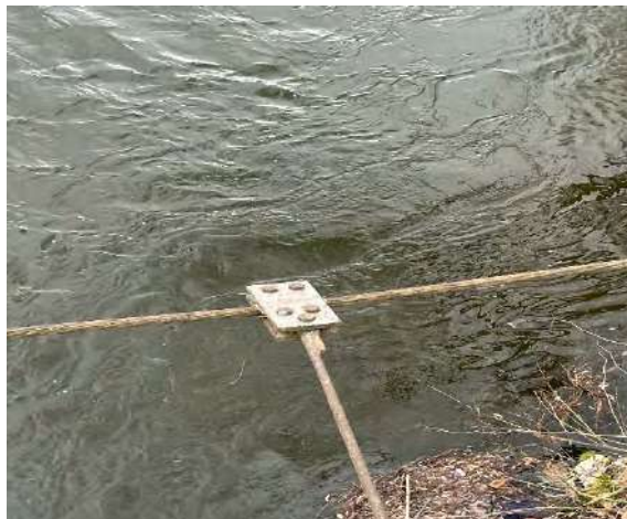
Figura 2. Uzura cablurilor și a elementelor de susținere
