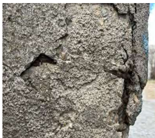
Figura 5. Fisuri în pilonii de beton
