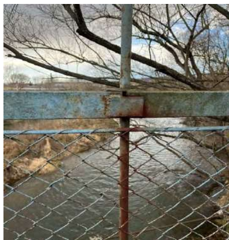
Figura 9. Coroziunea balustradei la prinderi
