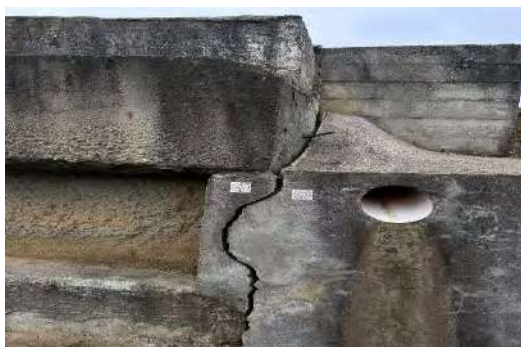
Figura 1. Fisura observată pe zidul de sprijin. (sursă proprie)
