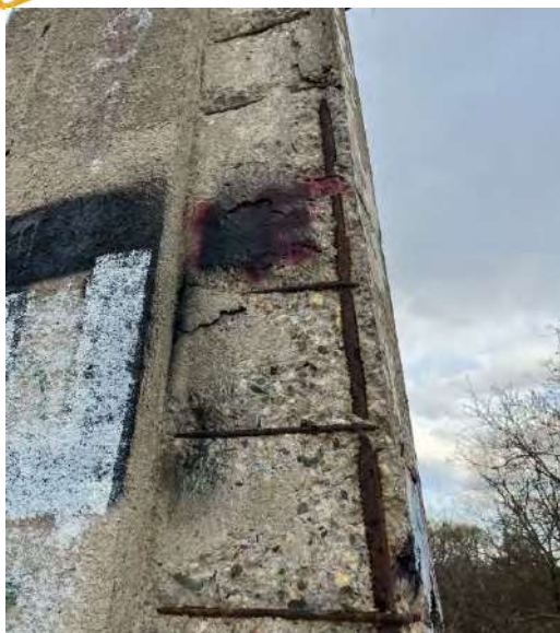
Figura 6. Coroziunea armăturilor descoperite
