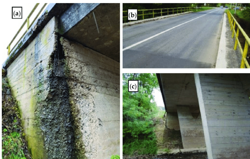
Figura 12. Infrastructura rutiera corodată.
