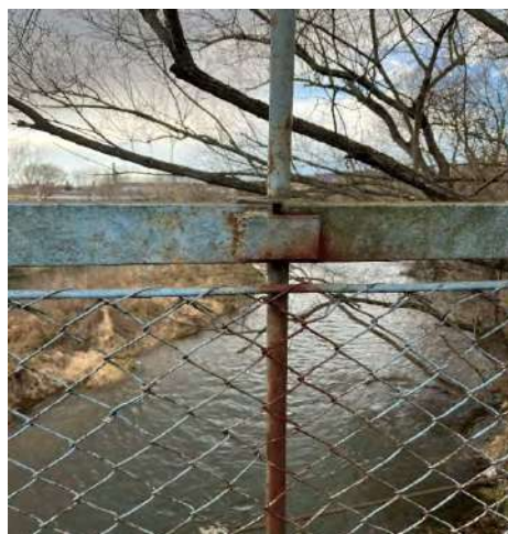
Figura 9. Coroziunea balustradei la prinderi
