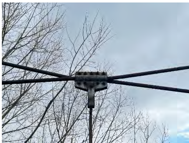
Figura 3. Uzura cablurilor și a elementelor de susținere
